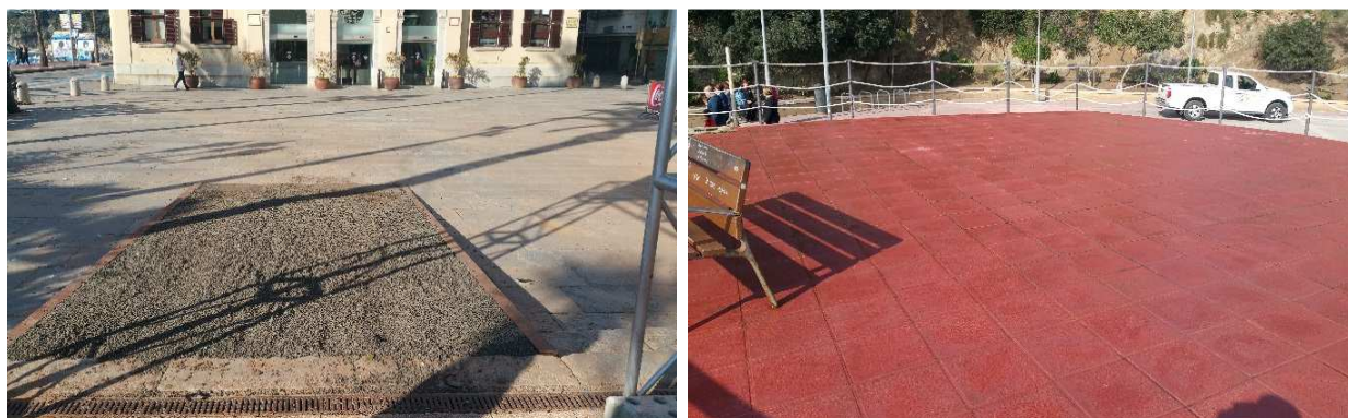
FOTOS 69 i 70: Rampa de grava a les escales de la plaça de la vila per la sortida dels vehicles del Rally Històric i neteja amb aigua de l'altell de la plaça Manel Bernat.
