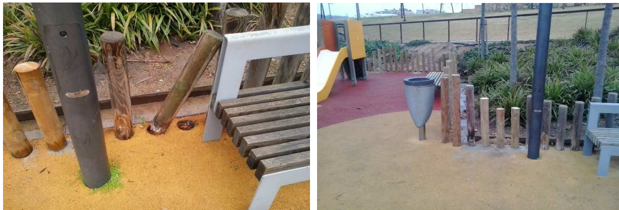
FOTOS 89 i 90: Reparació dels pals arrencat de la tanca perimetral del parc infantil de Can Saragossa.
