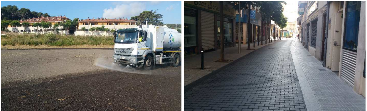
FOTOS 45 i 46: Reg del pàrquing d'autobusos de l'avinguda de Fenals per que les brigades municipals puguin compactar el terra després d'aplicar grava i estat de neteja del paviment del carrer Prat de la Riba.
