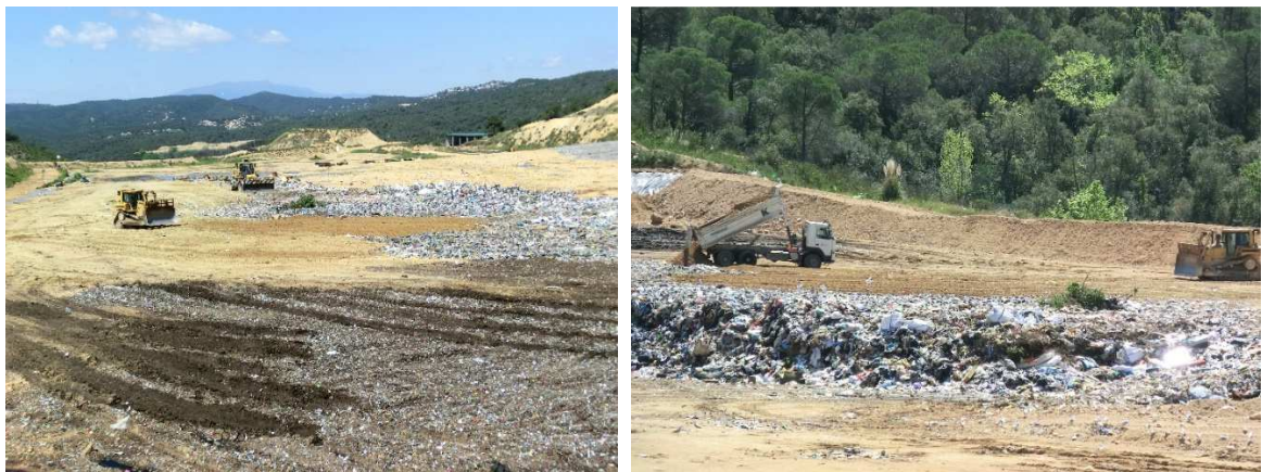
FOTOS 3 i 4: Cel·la actual d'exploració. Es pot veure l'estesa i cobertura de terra i material estabilitzat procedent del CTRM.
