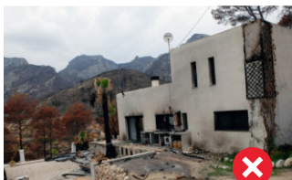
Vegetació massa a prop de la façana.
